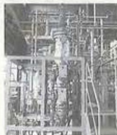
マイクロ波反応塔を 備えたバイオマス変 換プラント
