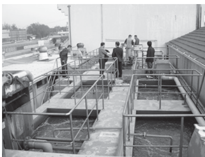
図2. 光合成細菌の標準的な排水処理装置（水産加工排水，台北（台湾）稼働中）。余剰汚泥は台湾高山茶の有機肥料として活用，優良茶を生むと好評。
