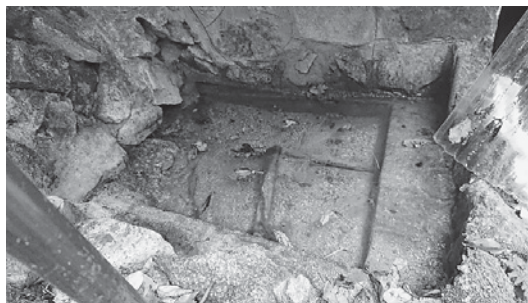
図2. 水害後の源宗坊名水水源。普段は蓋をして落ち葉などの混入を防いでいる。
